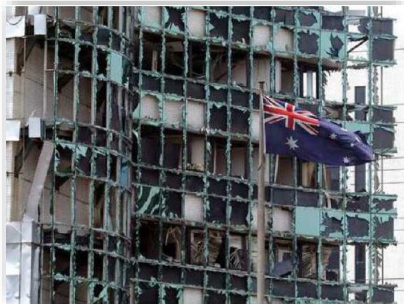
Figura 2 – Imagem da fachada envidraçada da Embaixada Australiana em Jakarta, após o atentado terrorista de 2004
